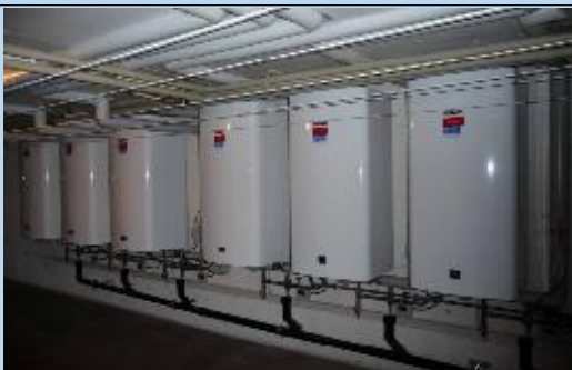
Abb. 4: Die ineffiziente Warmwasseraufbereitung kann durch einen zentralen Boiler einfach optimiert werden
