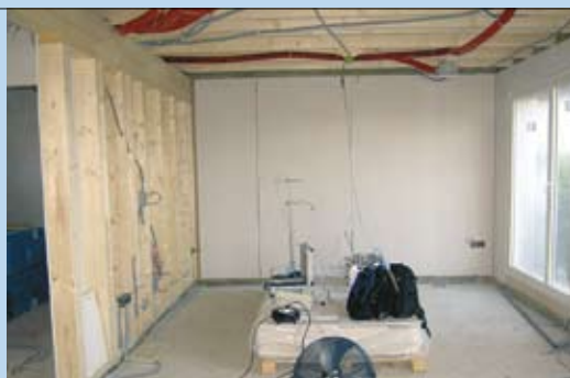
Abb. 4: Messungen des Luftwechsel mit der SF 6 -Methode in einem Studienobjekt nach Rohbauende.
