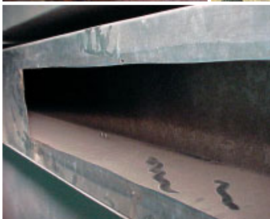
Praxisbeispiele verschmutzter Lüftungsanlagen
