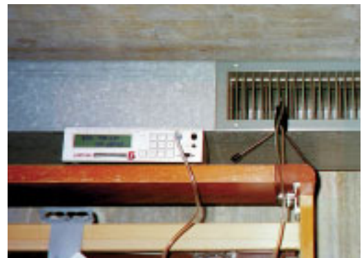
Bild 2: Feinstaubmessung in der Zuluft
